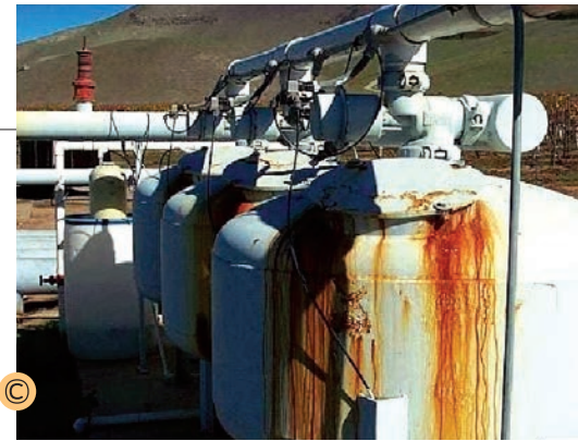
Los filtros no están funcionando apropiadamente
