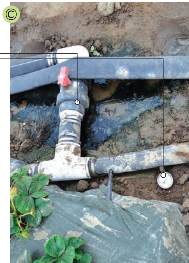
Mantenimiento del sistema
